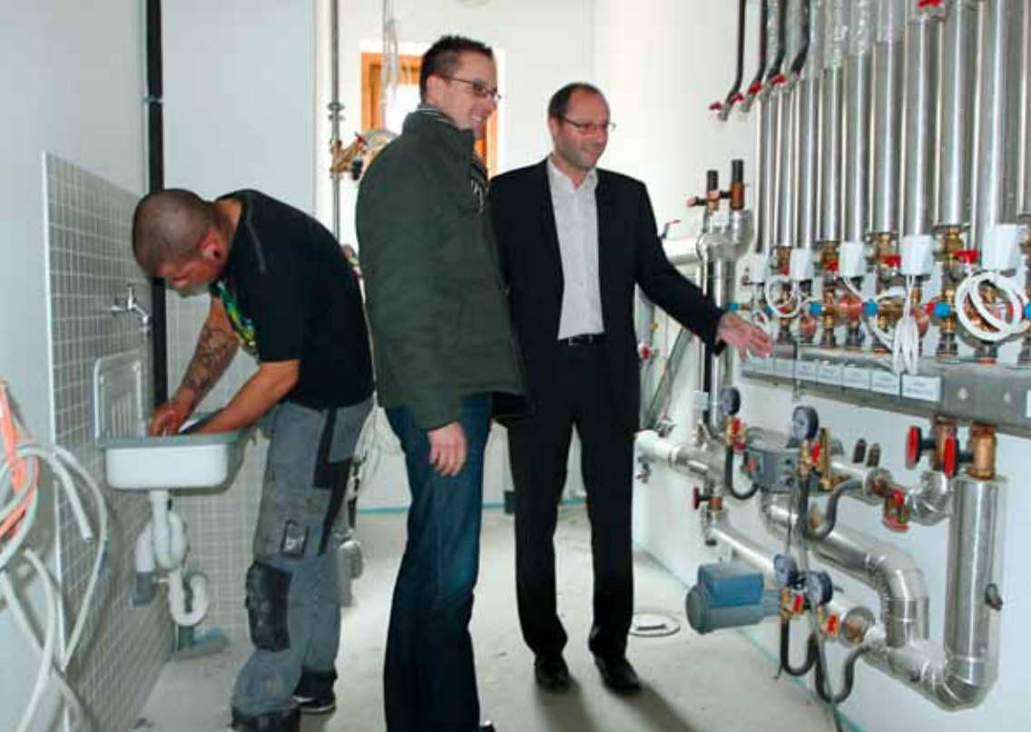
➡ Uwe Bothe im Hausanschlussraum des neuen Studienkollegs am Sokratesplatz. Gemeinsam mit Projektleiter Markus Mönikes von der Gebäudemanagement Schleswig-Holstein AöR begutachtet er den Heizungsverteiler.
